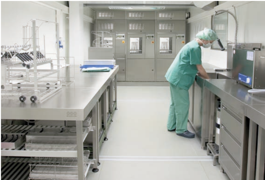
Containerbasierte Modulare Sanitätseinrichtung, Gesamtansicht des „unreinen Bereichs“ mit Thermodesinfektoren.
